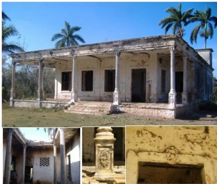
Fig. 39. Casa vivienda del central San Lino en total estado de abandono pero que muestra aún su integridad física que permite precisar sus principales características.
